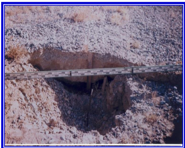
Рис.1. Просадка грунта на низовом откосе Султансанджарской плотины
